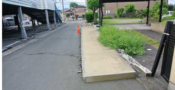
道路をふさぐ倒れたブロック塀
